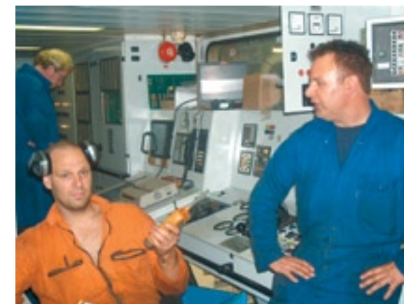
Collega's van Henk van der Plas in de machinekamer van de SCH 54 tijdens de renovatie in 2007.
